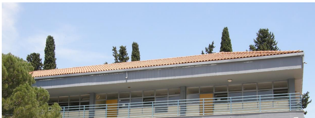
Εικόνα 7: Οροφή σκυροδέματος κάτω από μη θερμομονωμένη στέγη Λυκείου Άστρους
