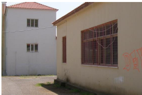
Εικόνα 23: Τυπικό άνοιγμα με μεταλλικό πλαίσιο και μονό υαλοπίνακα
